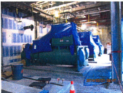
New 950 Ton Chillers
